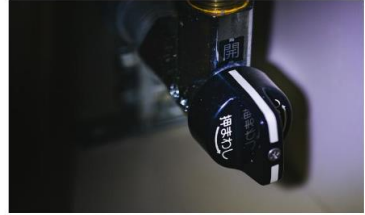
ガス漏れなど見えない危険も
